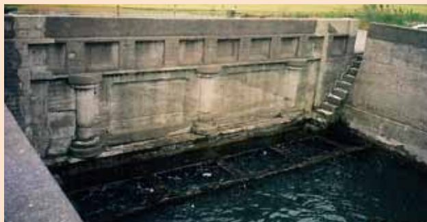
第1号樋門裏面製水ゲート
